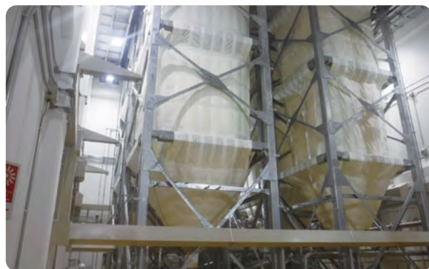
ニッポンエンジニアリング(株)が施工した布サイロ
