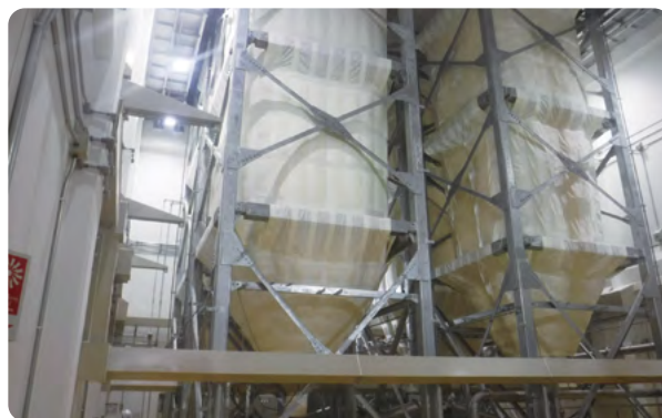
ニップンエンジニアリング(株)が施工した布サイロ
